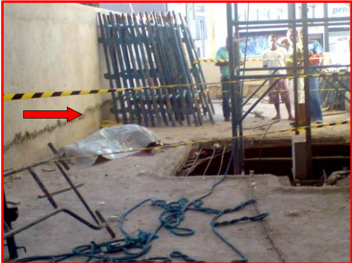
ACIDENTE FATAL DEVIDO QUEDA DE TRABALHADOR, ALTURA DE 13 METROS, AO DESMONTAR UM GUINCHO.
