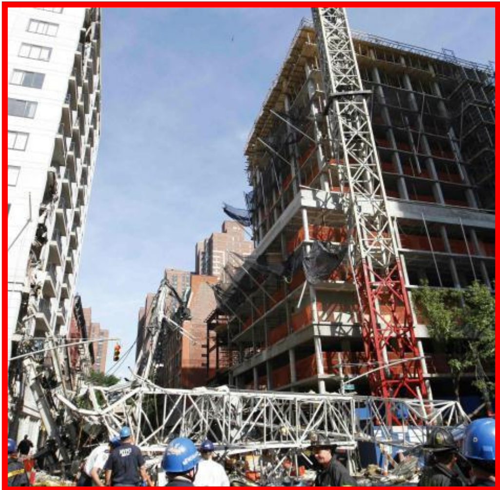
Foto Nº 1 Destroços da Grua que caiu.
