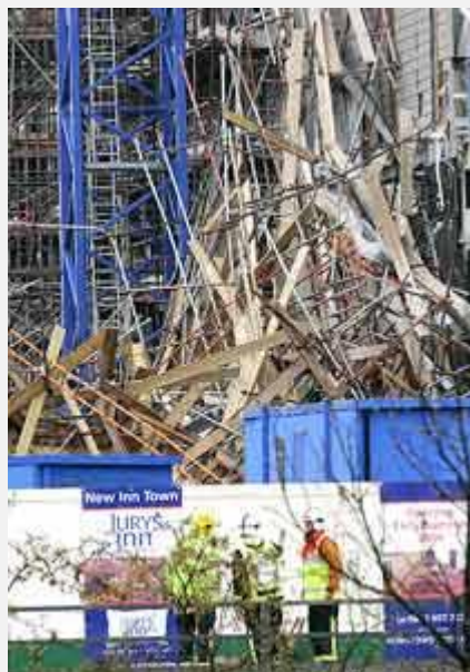
Queda de andaime em construção deixou 3 trabalhadores feridos
