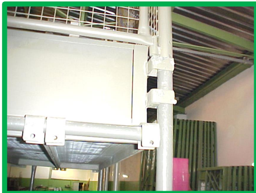
FOTO Nº 19 Detalhe da fixação do piso metálico em relação à estrutura do andaime.
