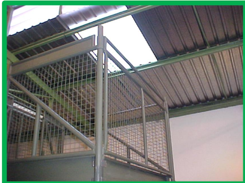
FOTO Nº 15 Guarda-corpo, barra para prender o cinto de segurança e rodapé.
