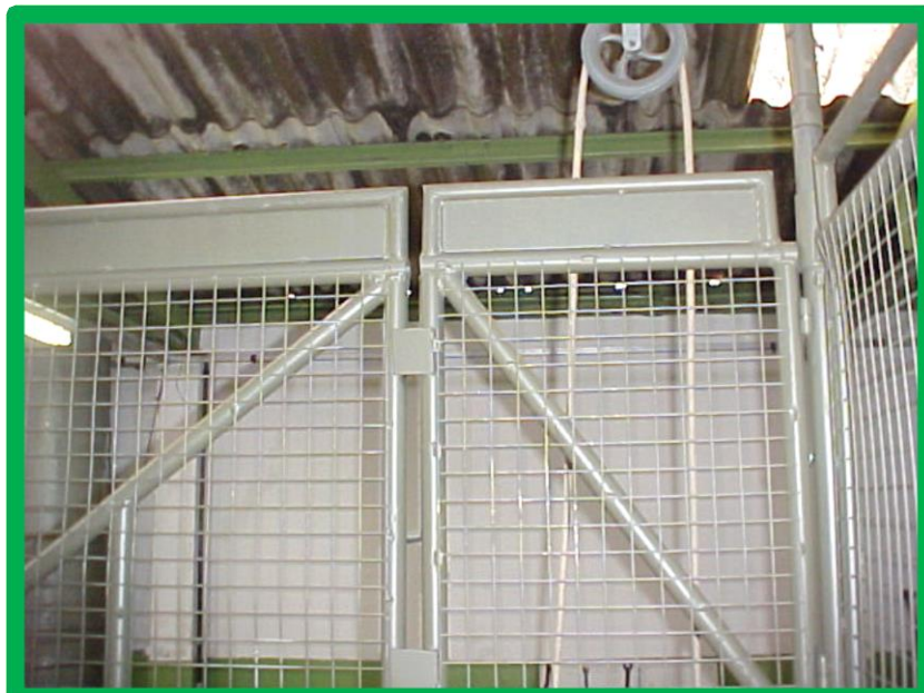
FOTO Nº 04 Porta de içamento fechada.
