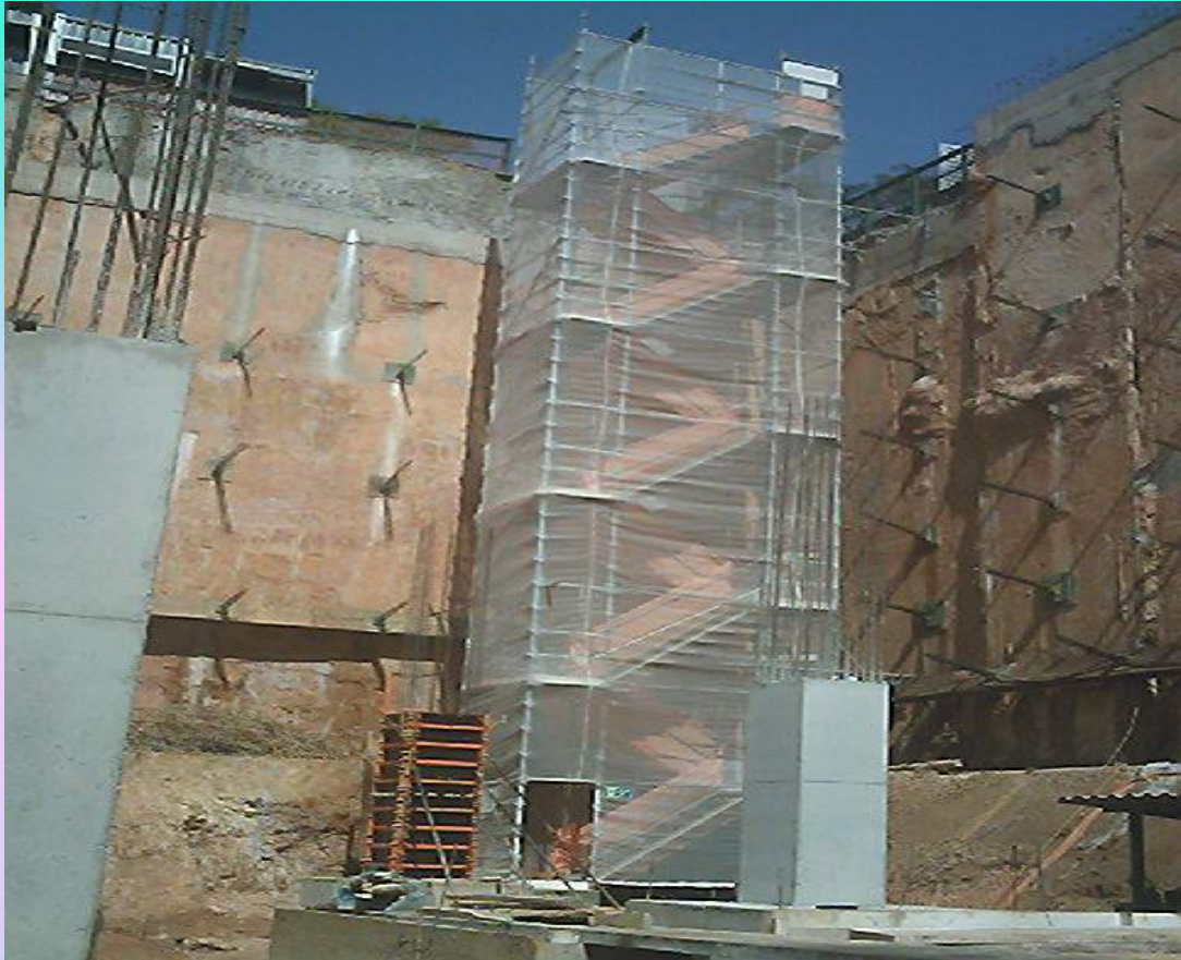
ESCADA DE USO COLETIVA METÁLICA
