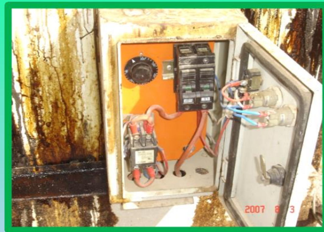
PAINEL ELÉTRICO DO RECIPIENTE
