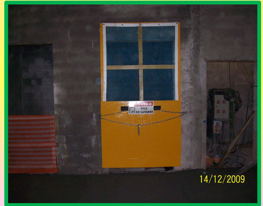
PORTA DE ACESSO COM CADEADO POÇO DE ELEVADOR
