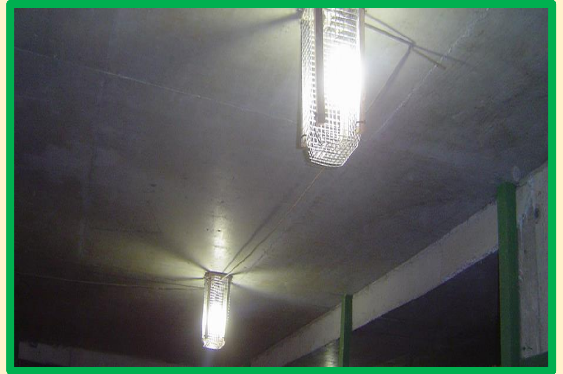
PROTEÇÃO DAS LÂMPADAS
